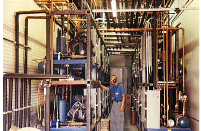
Figure 228B 철 사각 Rack 위에 콘덴서 코일이 없는 콘덴싱유니트를 설치하고 시운전. 1998년 필자가 Los Angeles 아씨마켓 냉동 냉장 설계하고 설치.
