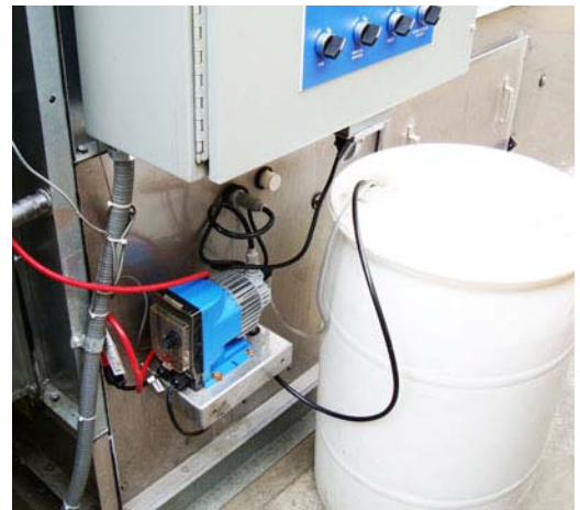
Figure 254 Cooling Tower에 설치한 케미컬 펌프와 스케일 제거 화학용액 탱크
