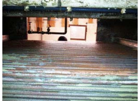
Figure 252 Evaporative Cooling Tower 에 스케일이 끼는 현상
