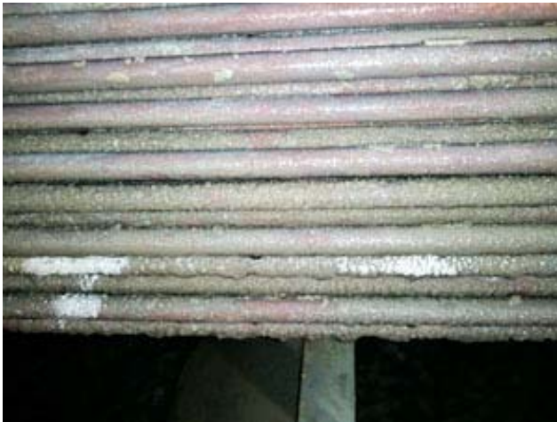
Figure 253 Evaporative Cooling Tower에 두껍고 단단한 스케일이 물렁 물렁하여지는 상태
